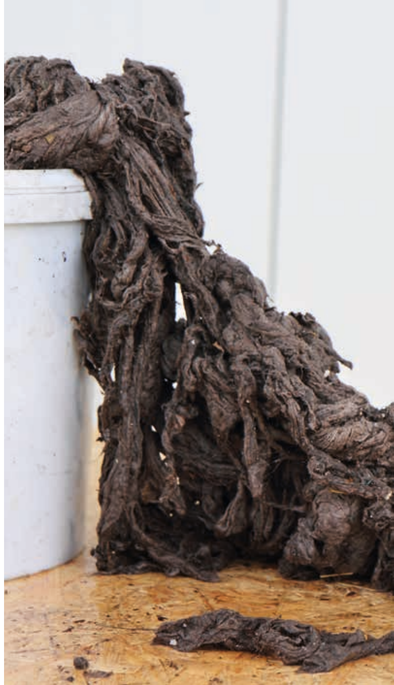
缠绕性湿巾和纤维导致堵塞和运行中断。
